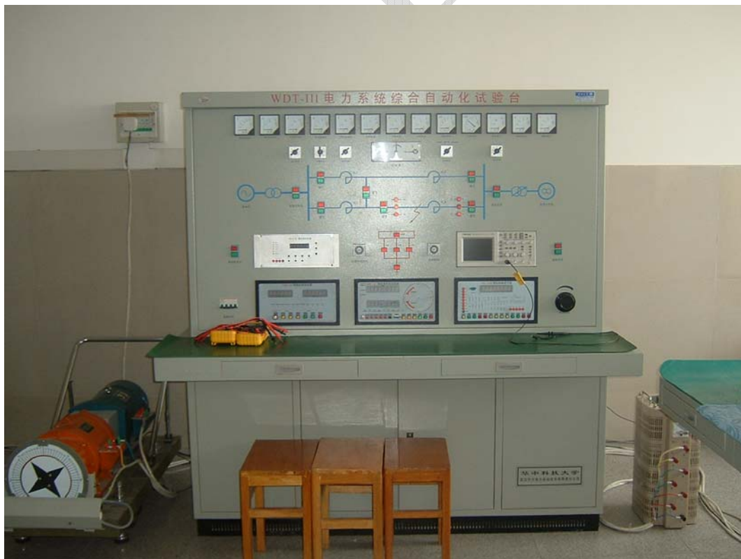
图1 WDT-III型电力系统综合自动化试验装置现场图
